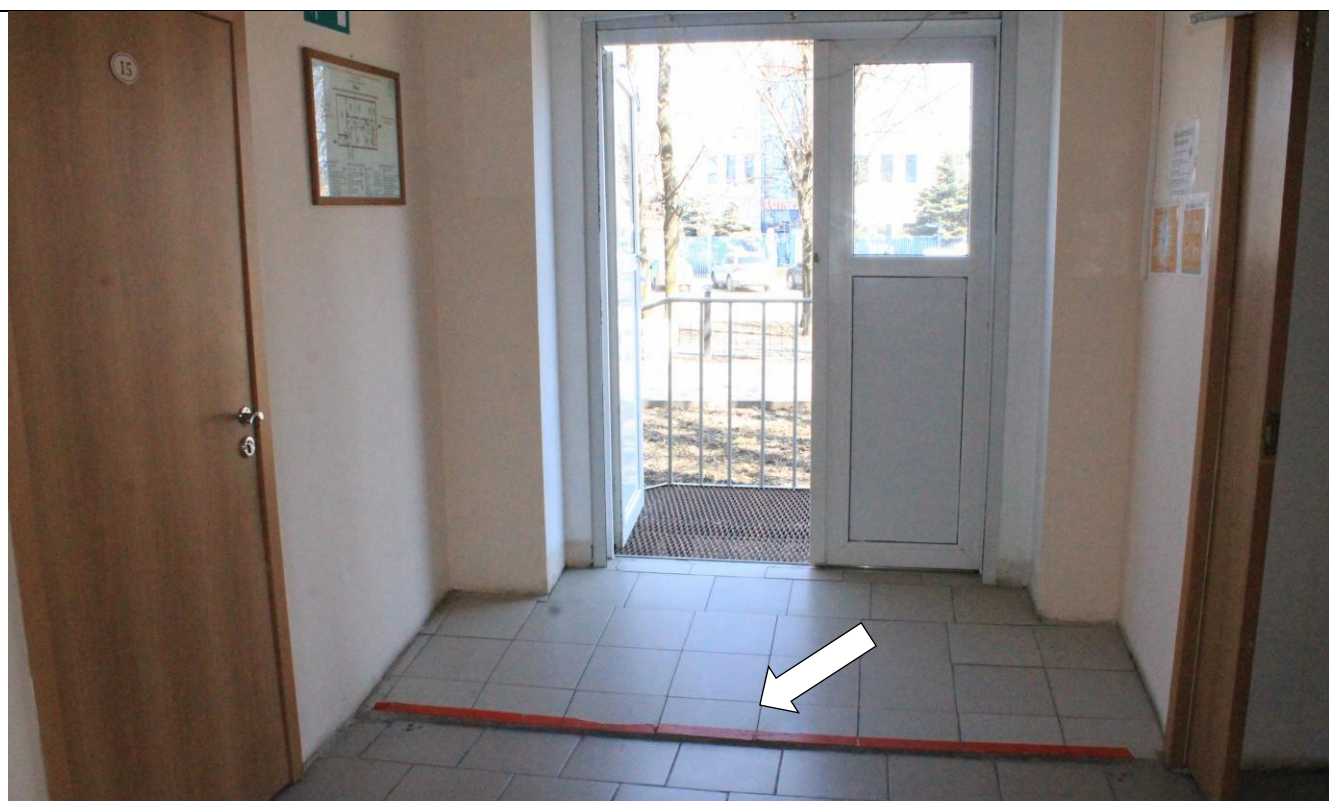
Фото № 10. На входе имеется перепад высоты сглаженный ненормативным пандусом.
