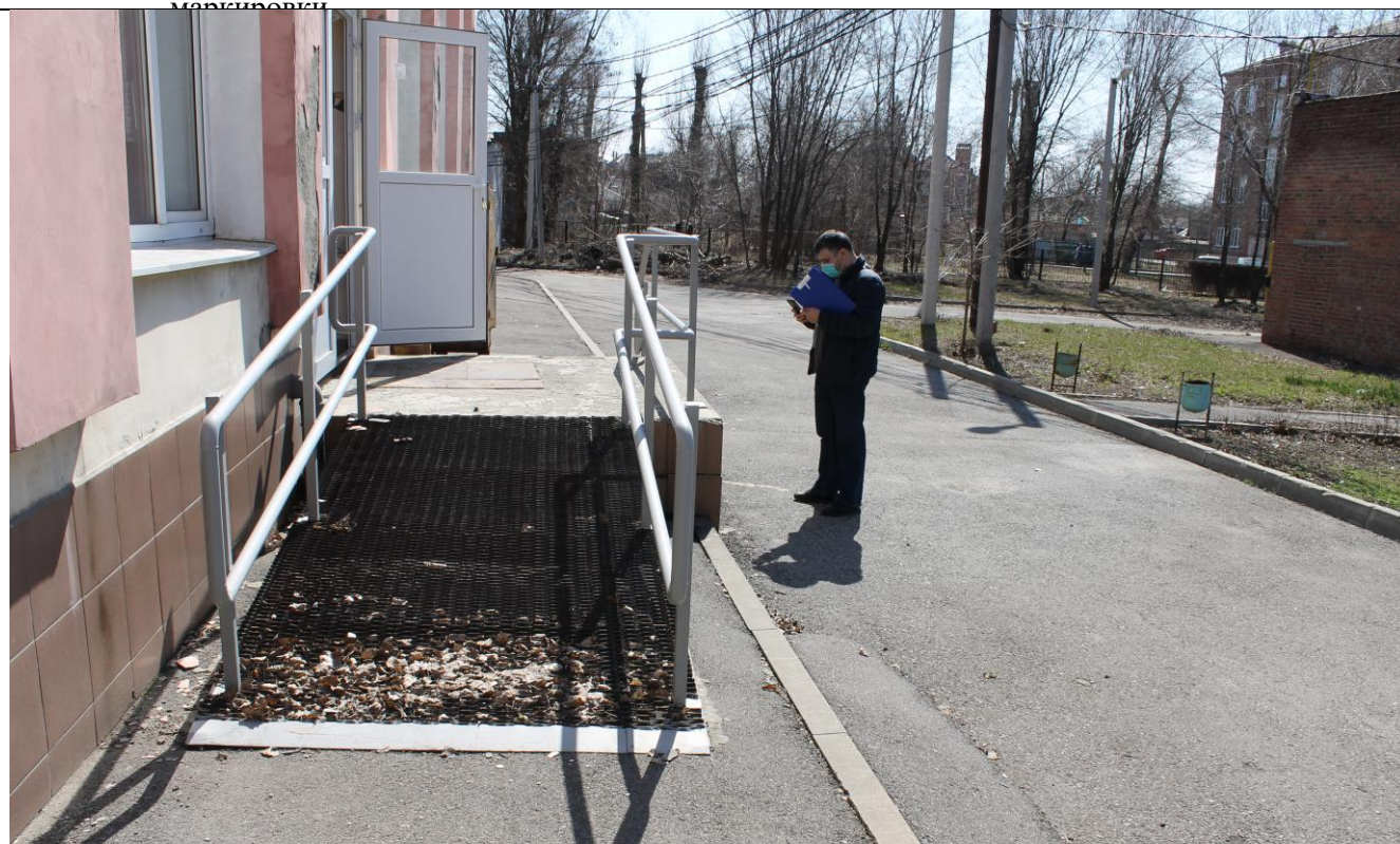
Фото № 6. Большое расстояние между поручнями пандуса.
