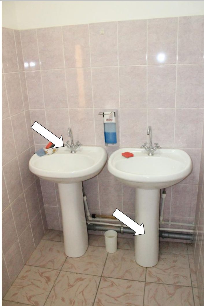
Фото № 25. Раковины установлены на пьедесталах. На раковинах установлены краны поворотного типа.
