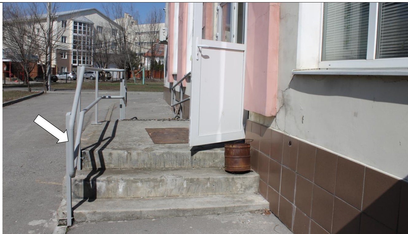
Фото № 7. Ступени лестницы неодинаковой высоты и геометрии. Нет контрастной маркировки ступеней лестницы. Поручень установлен с одной стороны лестничного марша.
