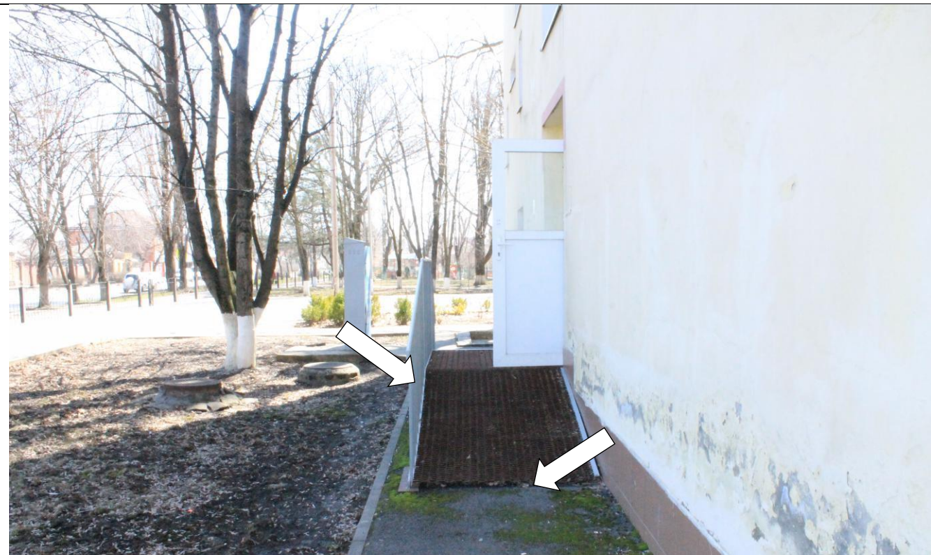
Фото № 9. Поручень на пандусе установлен с одной стороны, в одном уровне.
