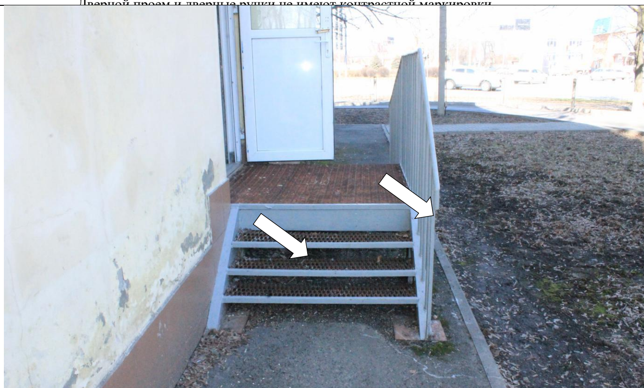
Фото № 8. Ступени лестницы не имеют подступенка. Нет контрастной маркировки ступеней лестницы. Поручень установлен с одной стороны лестничного марша.
