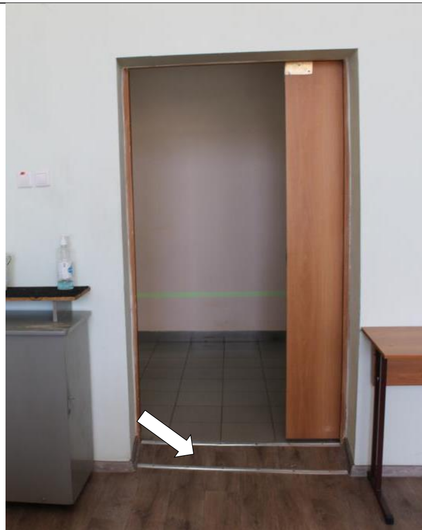
Фото № 20. Перепад высоты на входе в кабинет.
