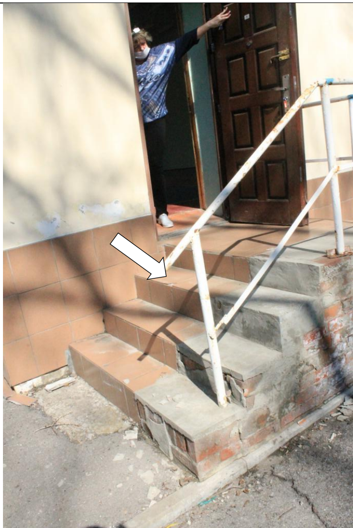
Фото № 19. На эвакуационном выходе покрытие входной площадки и ступеней лестницы имеет нарушение целостности.
