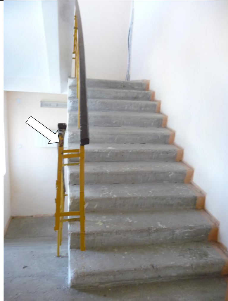
Фото № 14. Поручни на лестнице установлены с одной стороны лестничного марша, имеют травмирующее завершение прерываются по длине. Нет контрастной маркировки краевых ступеней лестницы.
