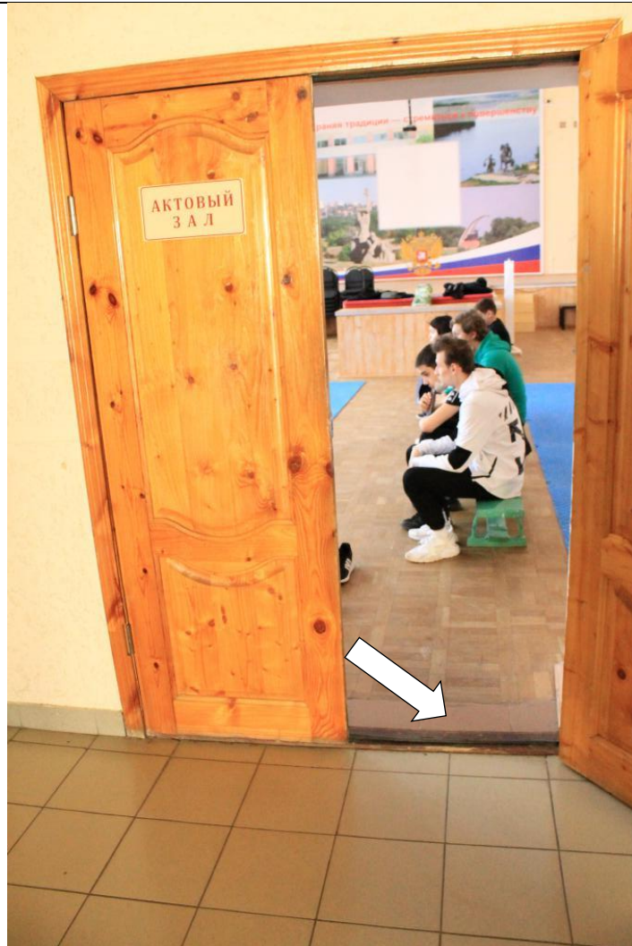
Фото № 21. Узкие двери. Порог в дверном проеме.
