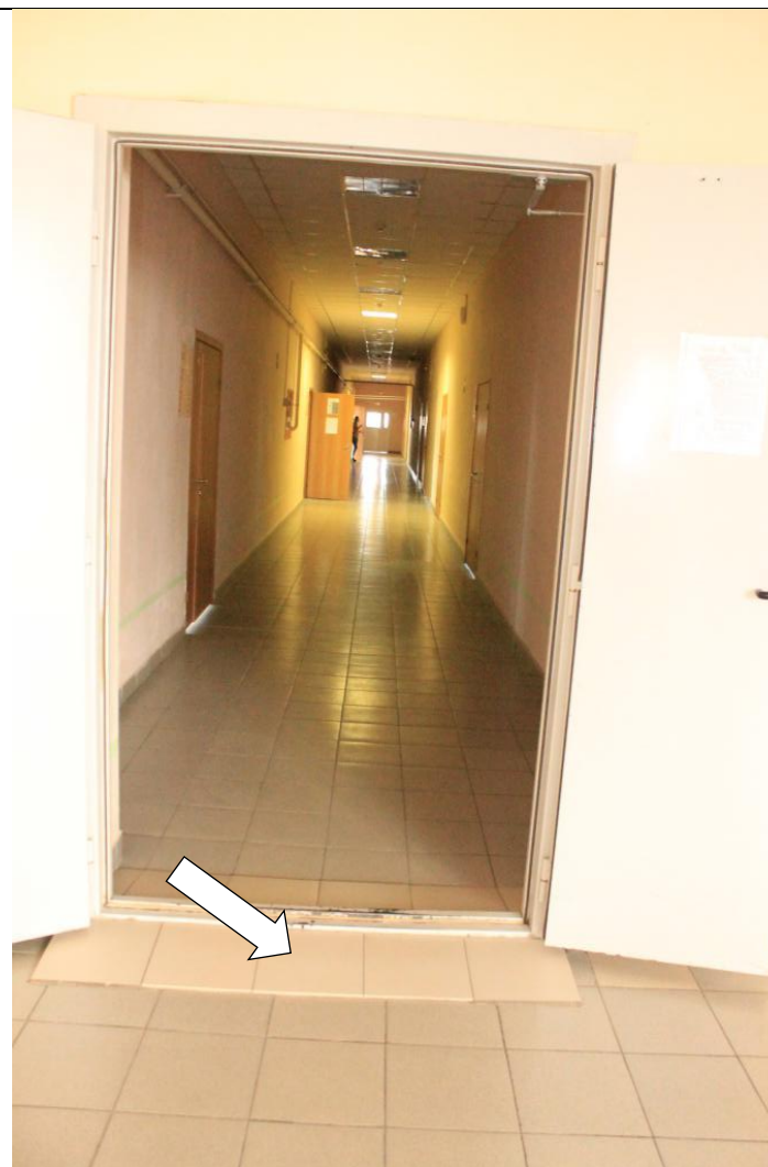
Фото № 18. В дверном проеме перепад высоты.
