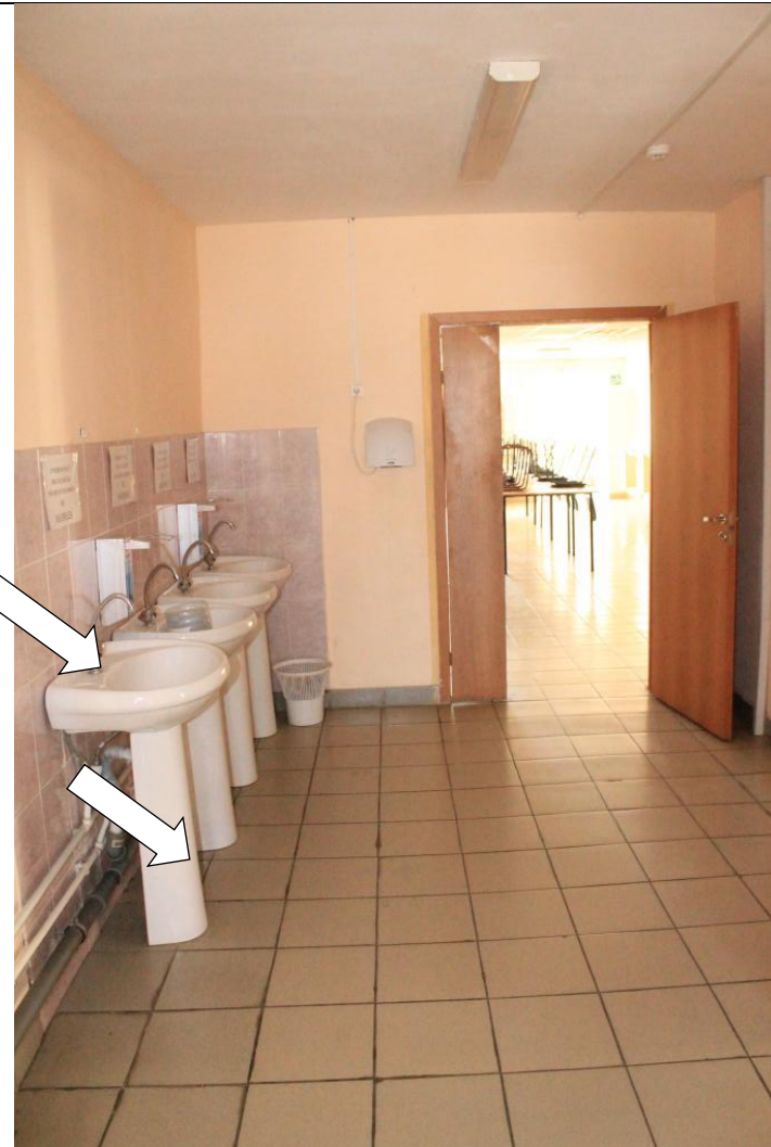
Фото № 22. Около столовой раковины установлены на пьедесталах. На раковинах установлены краны поворотного типа.
